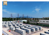
中国华能集团有限公司浙江分公司 储能方阵, 电映蓝天(华能浙江独立储能 项目一期)(韩立群摄)
