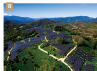
中国华能集团有限公司华东分公司 茶马古道上的光伏蓝海(华能普洱市第一批 集中式光伏项目)(丁思源摄)
